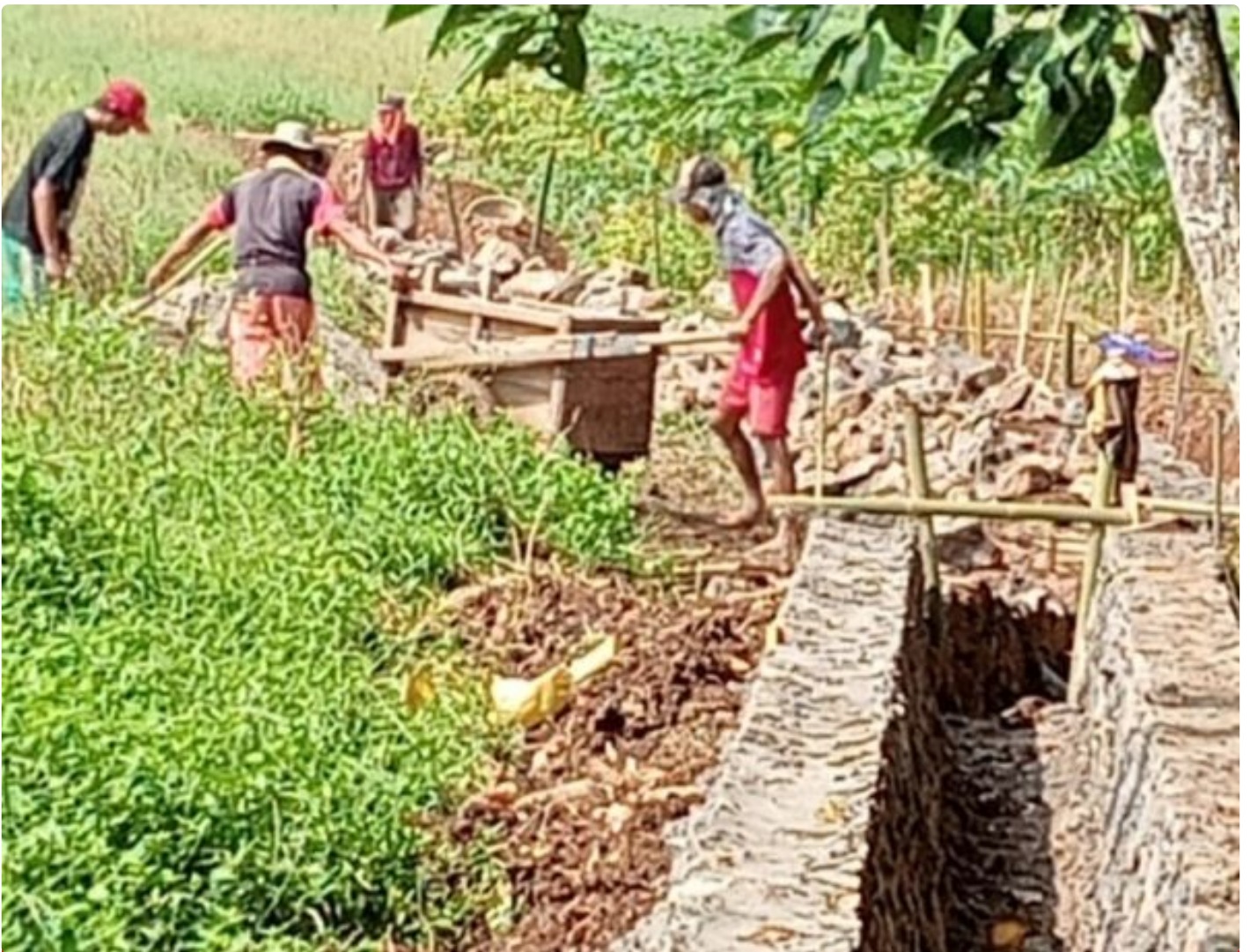
Jaringan Irigasi Desa Banyubiru Kecamatan Labuan Dibangun Melalui Dana Desa Tahap 1TA 2024
